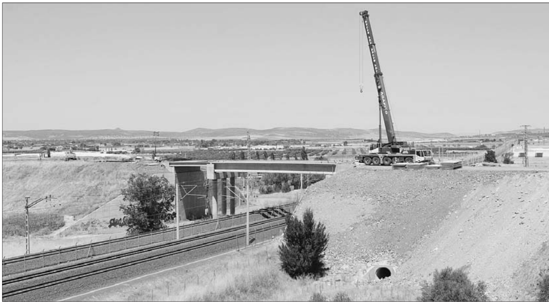
Estado de las obras del último tramo de la A-41 que unirá Argamasilla de Calatrava con la localidad de Puertollano. / PILAR G. MANZANARES
